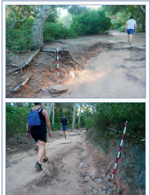
FIGURA 3. Trams del camí de cala Pilar. Observem encaixament d'ordre mètric de la secció de traça sobre morfologies dunars i denudació d'arrels.
