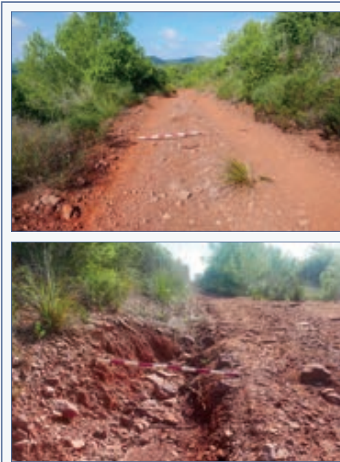
FIGURA 2. Trams del camí Reial sobre el Triàsic. Observem poca cobertura vegetal associada a la traça i sòls pobres amb presència de xaragalls.
